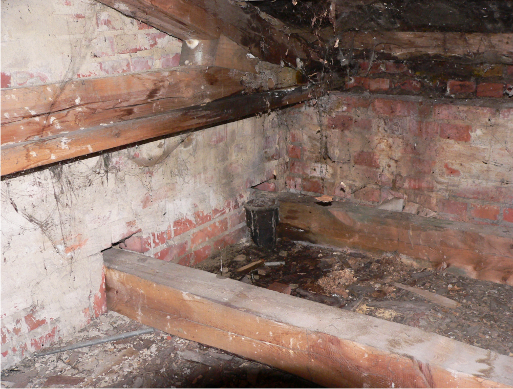
Poddasze- widoczne zawilgocenie dźwigara w strefie podporowej nad pomieszczeniami sanitariatów(północno-zachodni narożnik budynku głównego)
