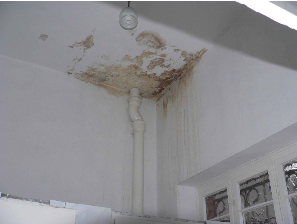
Sanitariaty -widoczne zawilgocenie stropu w północno-zachodnim narożniku budynku
