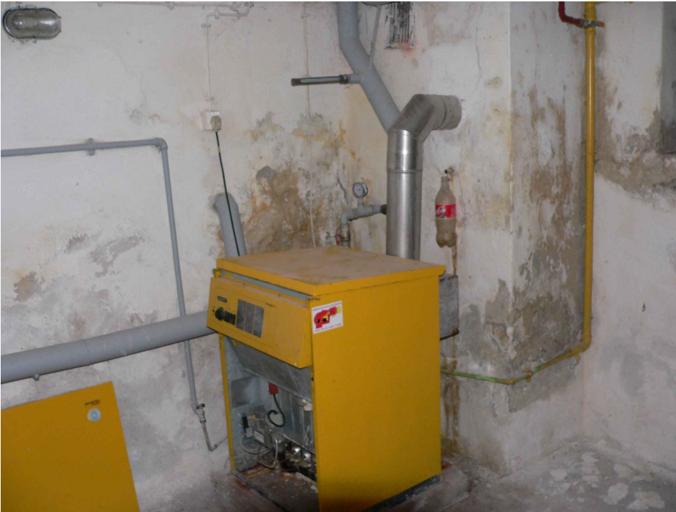
Kotłownia-piec gazowy oraz widoczne zawilgocenie ściany fundamentowej od strony ściany szczytowej budynku głównego
