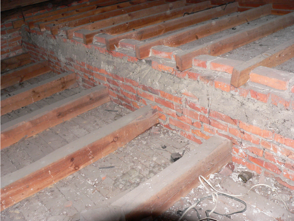
Poddasze-widok konstrukcji stropu między salą ogólną a częścią niższą (biblioteką i pomieszczeniami sanitariatów)
