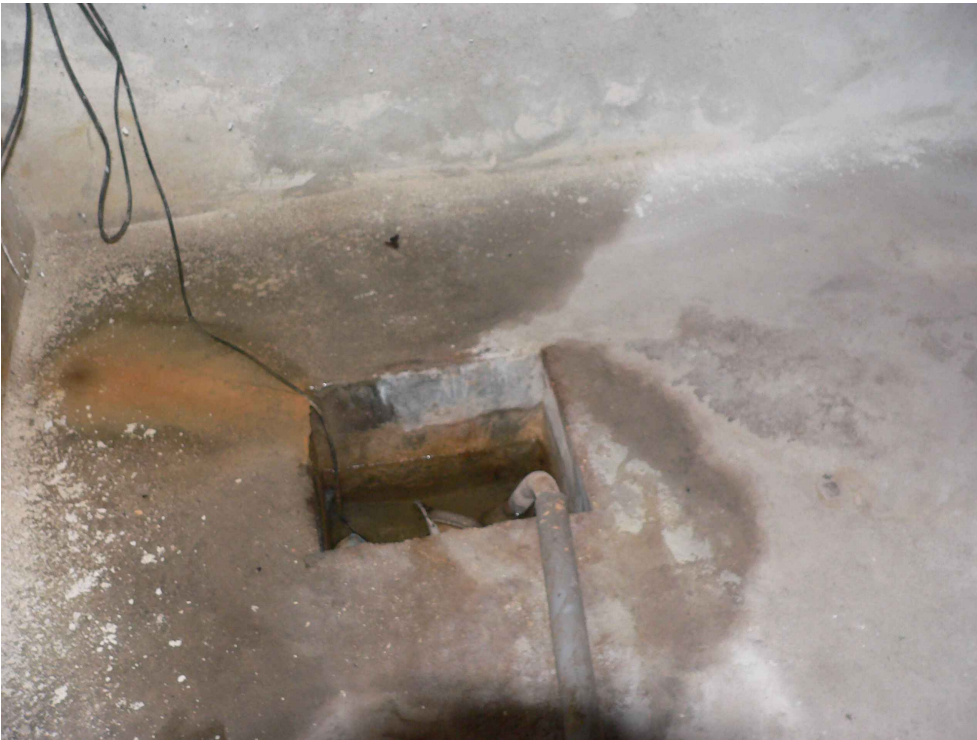
Kotłownia-studzienka odwadniająca, widoczne ślady po zalaniu posadzki
