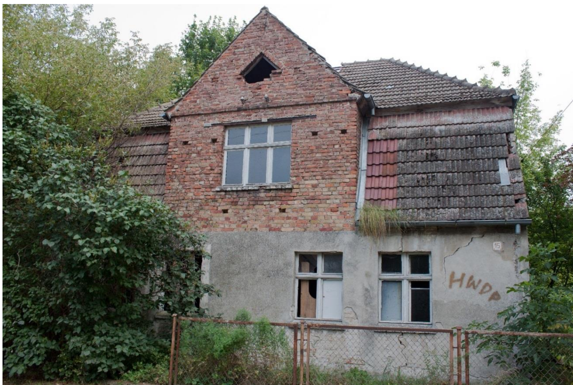
Zdjęcie 13 Stan techniczny niektórych budynków na terenie miejscowości Buk
