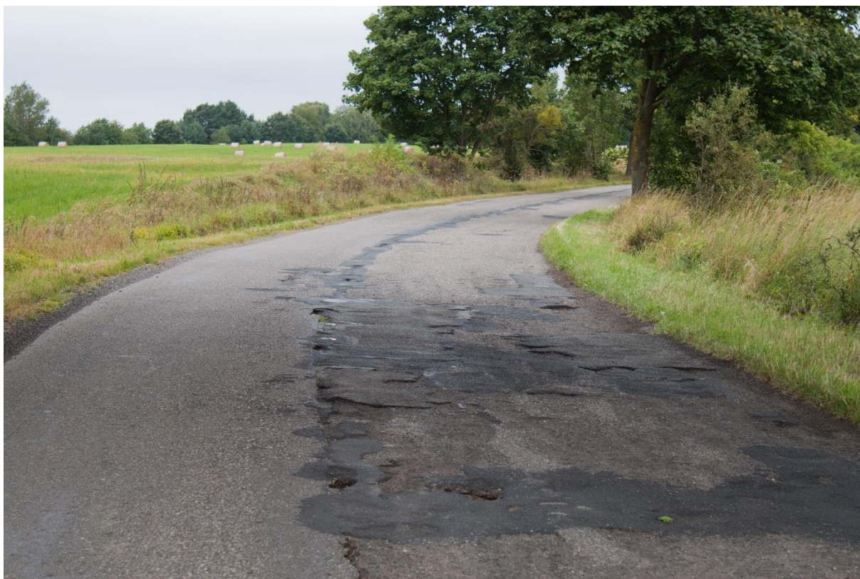
Zdjęcie 5 Stan techniczny drogi na odcinku Buk – Stolec
