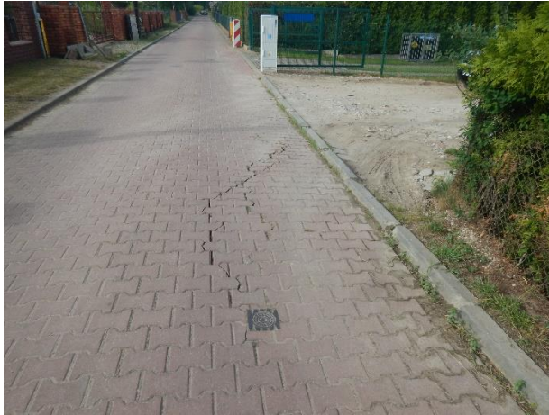
Zniszczenie drogi przy wjeździe na budowę, naprawiono.
