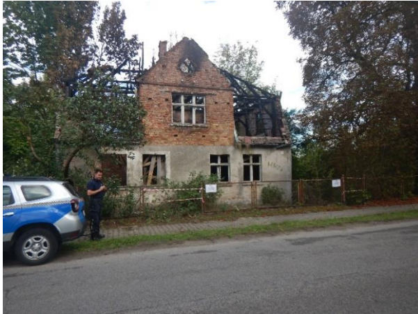
Zabezpieczenie pustostanu po pożarze.
